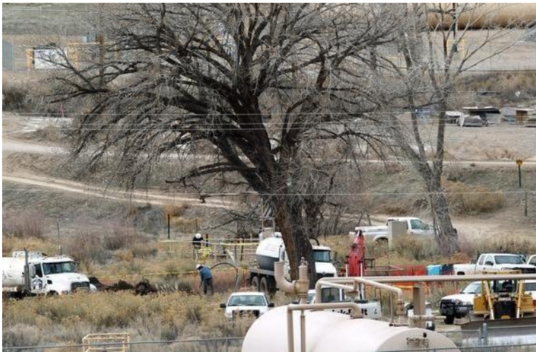
图片：2013 年 3 月 18 号星期一，工作人员在位于 Parachute Creek 天然气厂，Parachute 北部 4 公里的地方天然气泄漏的事故现场展开工作。
